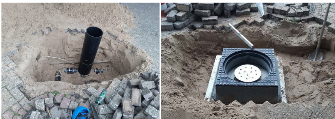
Foto's: Voorbeelden van voorzieningen voor controle van de bedrijfsriolering op waterdichtheid.
